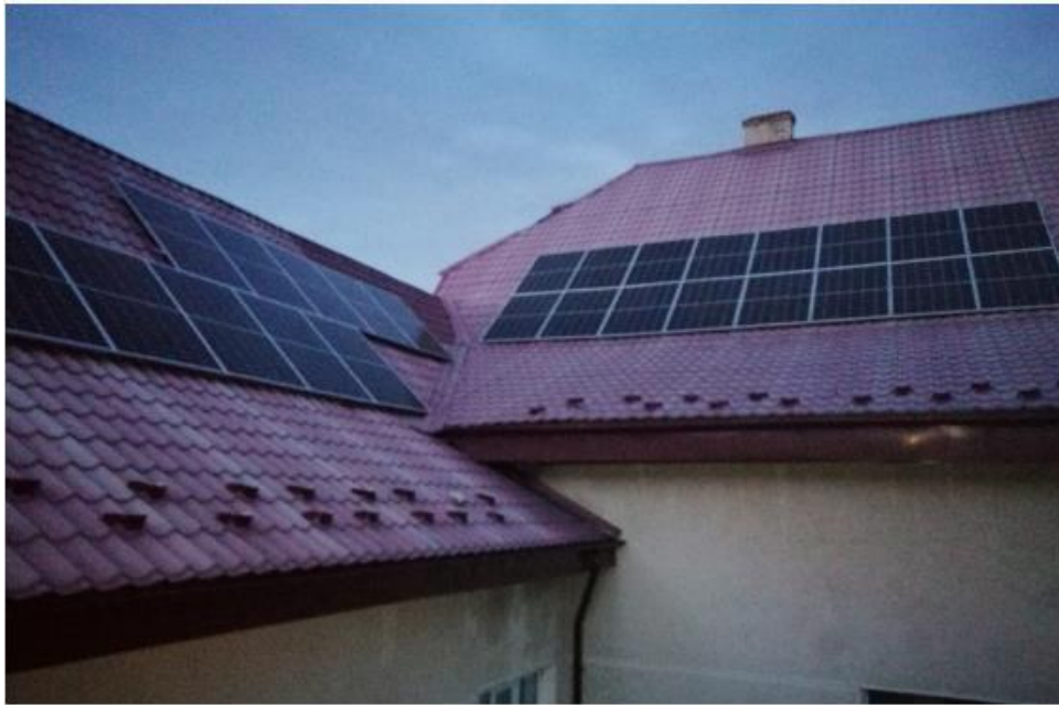
Рисунок 1.7 – Зображення СЕС на даху будівлі Делятинського ліцею №2
