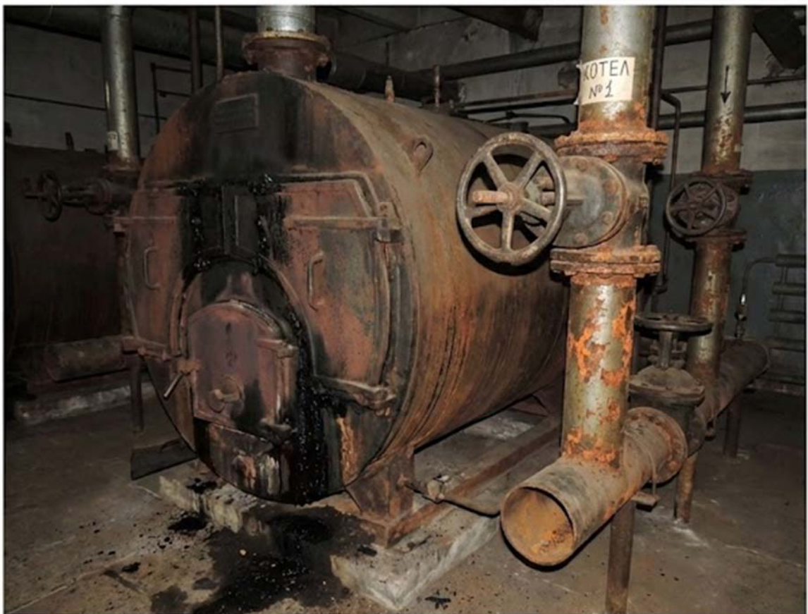
Рис. Б.1 Фотофіксація стану існуючого котельного обладнання. Видно ознаки низькотемпературної корозії, відкладення смол (наслідок тління) та відсутність сучасної запірно-регулюючої арматури.
