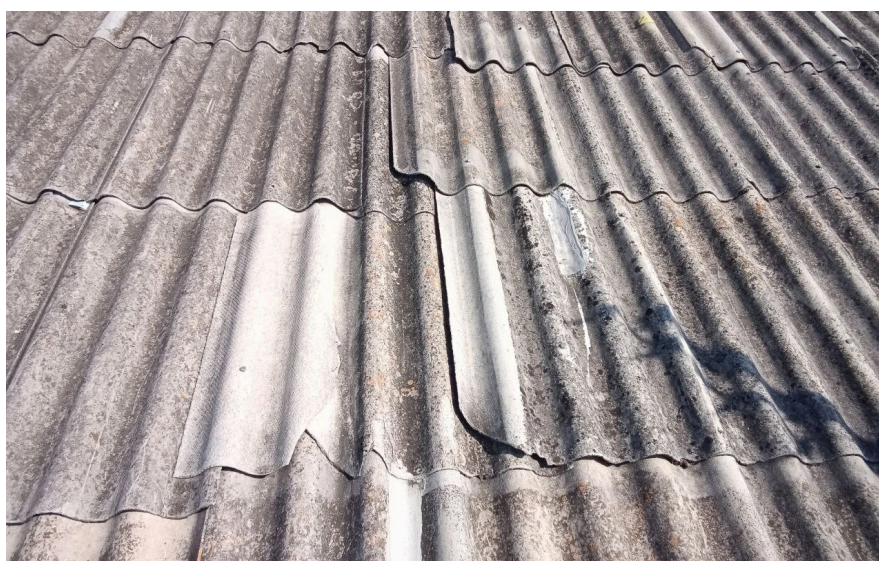
Рис. 12.3. Приклад пошкодженого шиферного даху.
