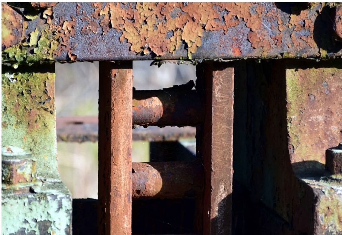
Рисунок 1.1 – Фото процесів корозії металічних конструкцій
