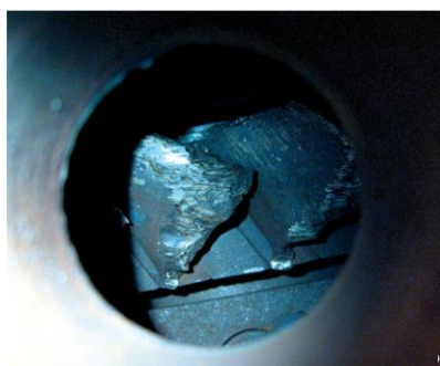
Рисунок 1.4 – Руйнування лопаток компресора внаслідок роботи в помпажному режимі
