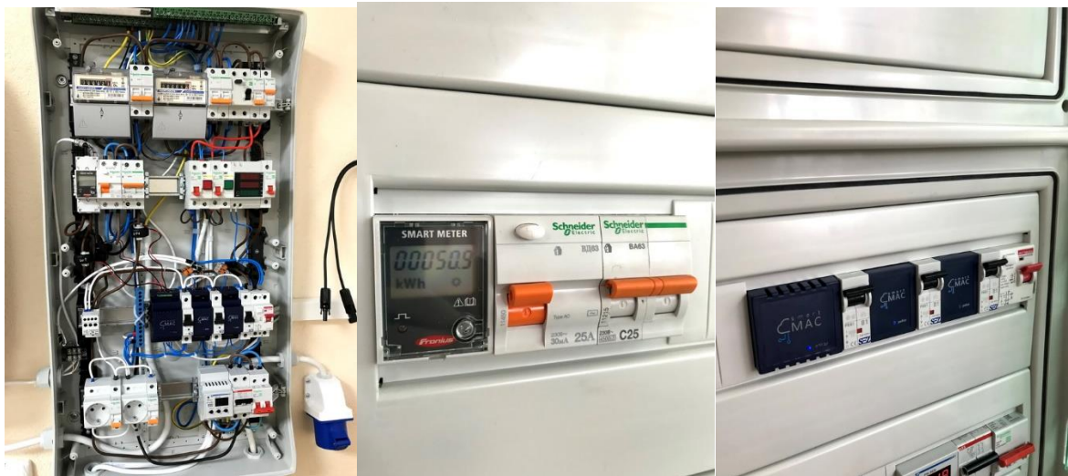
Рисунок 2.6 - Електрощит змінної напруги демонстраційної СЕС з встановленими засобами моніторингу і обліку електричної енергії
