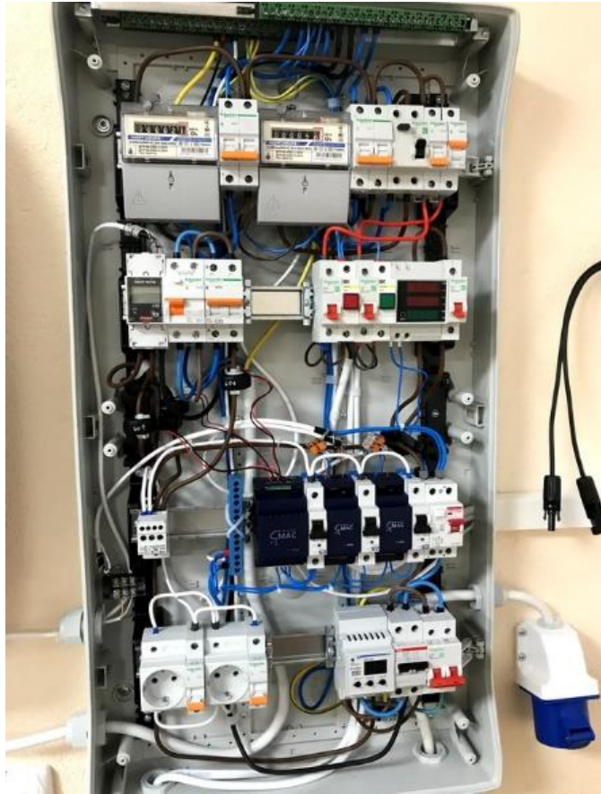
Рисунок 3.12 – Електрична щитова СЕС, де використано однофазний електромеханічний лічильник
