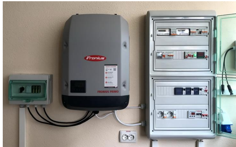
Рисунок 2.3 – Мережева сонячна електростанція в аудиторії 9201
