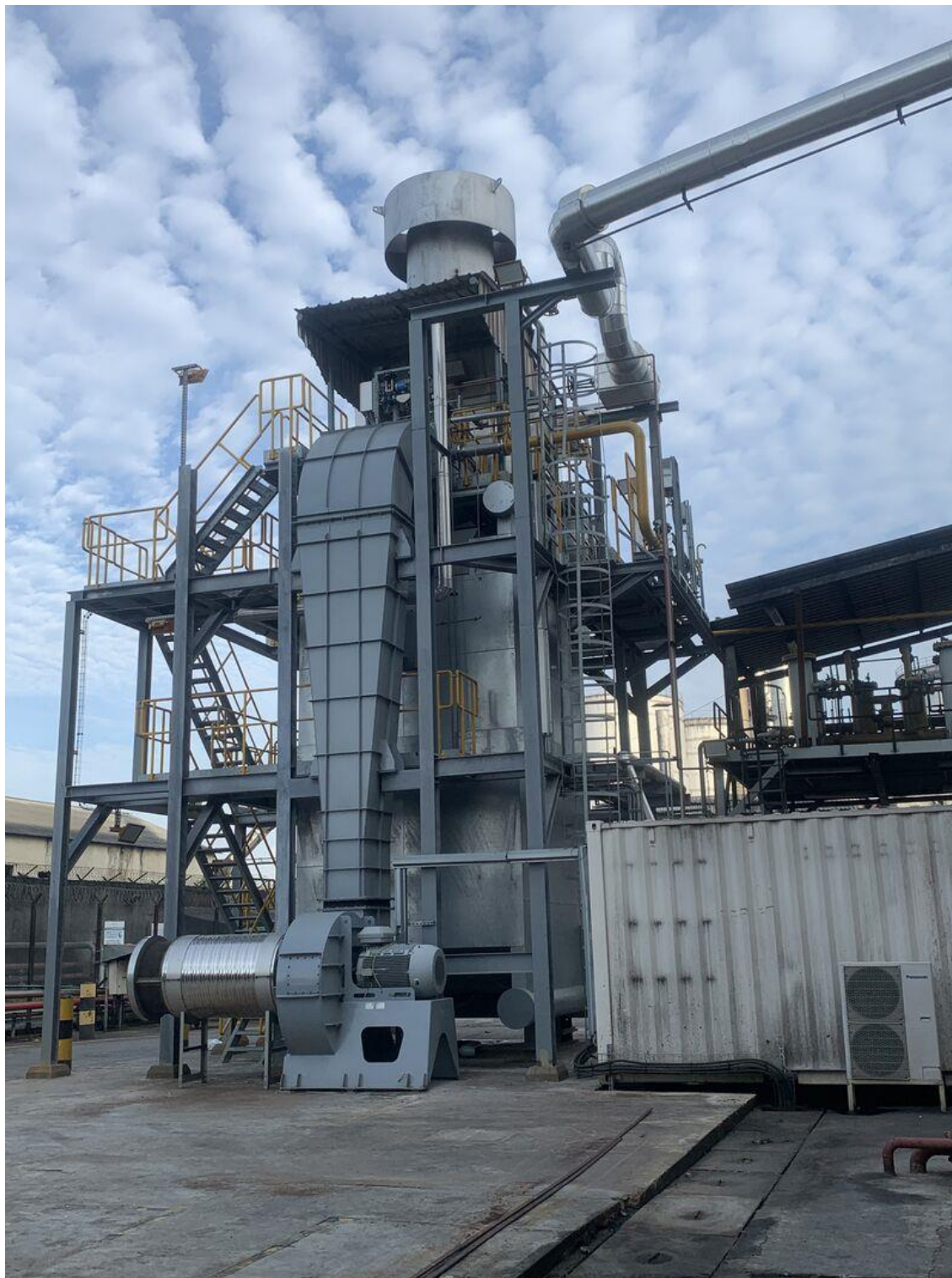
Рис. 1.2. Загальний вид водонагрівальної установки
