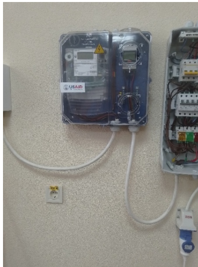
Рисунок 1.11 – Загальний вигляд розумного лічильника електроенергії
