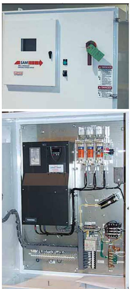
Рисунок 1.14 – Загальний вигляд шафи управління ШГНУ з контролером Lufkin Well Manager VSD RPC
