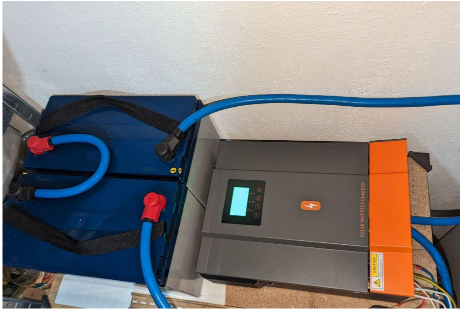
Рисунок 2.8 – Загальний вигляд станції
