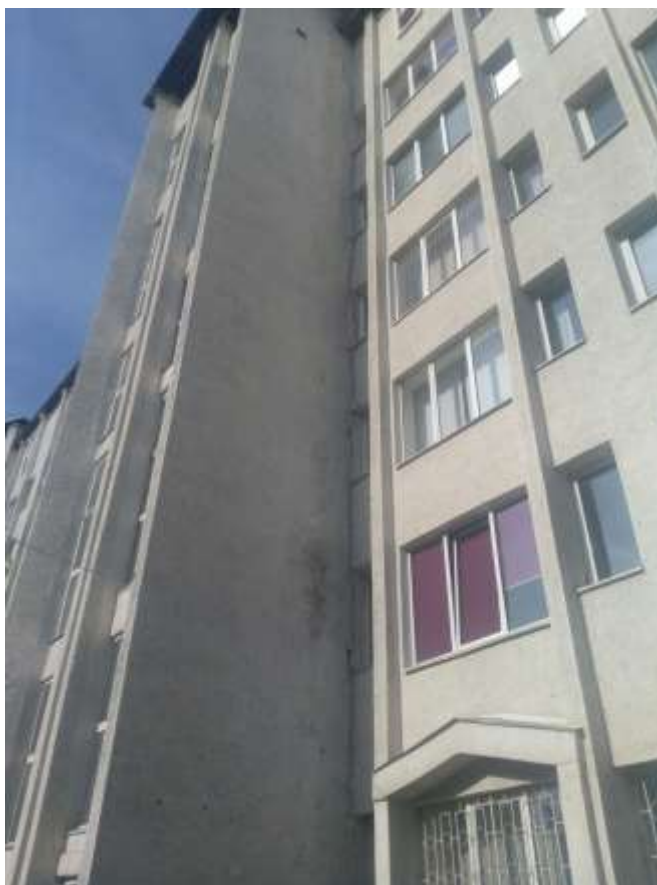
Рисунок 3.1 – Фотофіксація тріщини в районі сходової клітки правого крила будівлі
