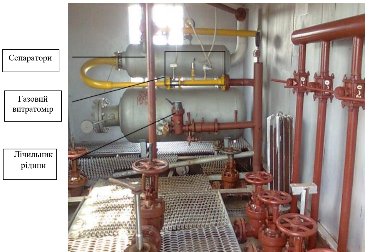
Рисунок 3.1 - Загальний внутрішній вигляд АЗГУ
