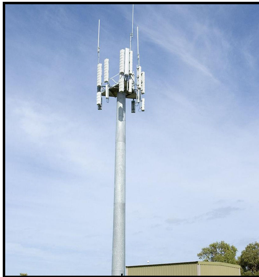
Рисунок 2.2 – Вежа (базова станція) мобільного зв'язку
