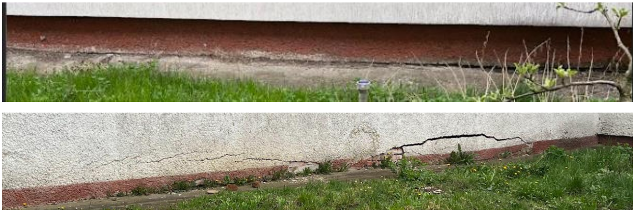
Рисунок 2.16 – Загальний вигляд цоколя та зруйнованого вимощення
