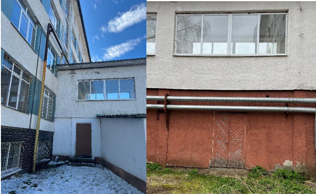
Рисунок 2.15 – Загальний вигляд стін будівлі та наявних пошкоджень (зовні)
