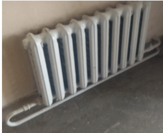
Рисунок 2.25 – Загальний вигляд опалювальних пристроїв будівлі
