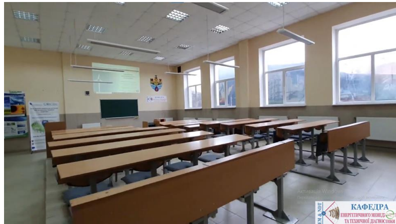
Рисунок 2.28 – Загальний вигляд світильників в будівлі
