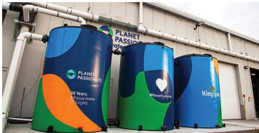
Рисунок 1.7 – Резервуари для збору дощової води на об'єкті Kingspan у місті Деленд, штат Флорида
