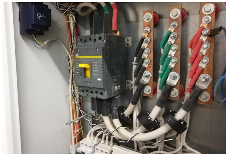
Рисунок 3.12 – Приклад встановлення приладів енергомоніторингу в електрощитовій (підключення через трансформатори струму)
