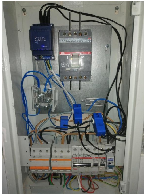
Рисунок 3.13 – Приклад підключення групи пристроїв для моніторингу споживання електроенергії та контролю роботи ФЕС
