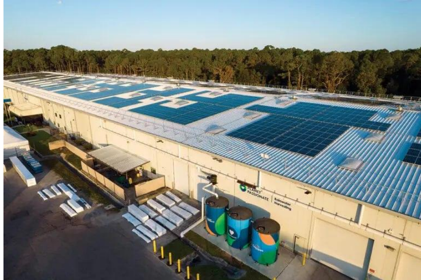
Рисунок 1.6 – Фотоелектрична система Kingspan потужністю 1,1 МВт на заводі у місті Деленд, штат Флорида
