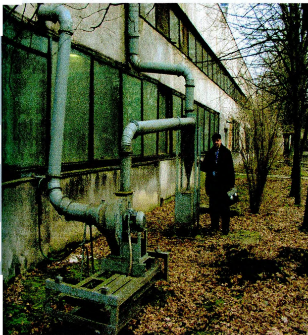
Рисунок 5.3- Установа для уловлення пилю при очистці поверхні локомотива в піскоструйній камері продуктивністю 3000 м 3 /год
